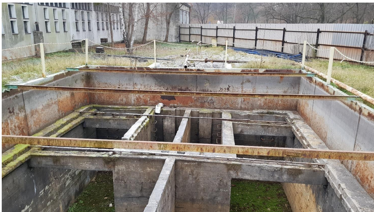
7. Zbiornik p.poż. przy budynku hydroforni 7
